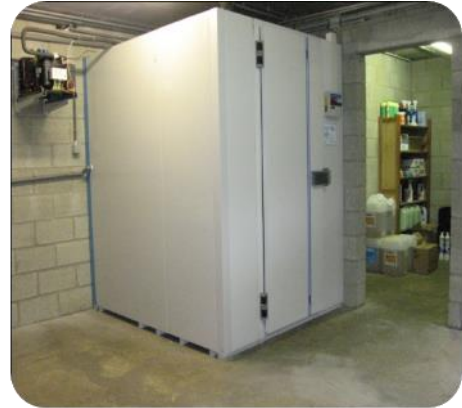
Figure 89 : La chambre froide Source : L'auteur
