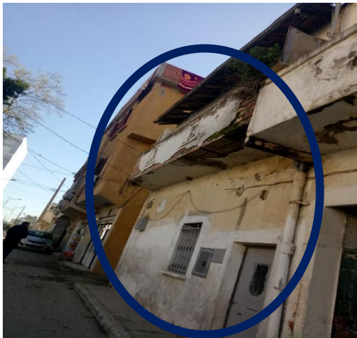
Figure n°36 : maison individuelle dans un état dégradé (la gare)
