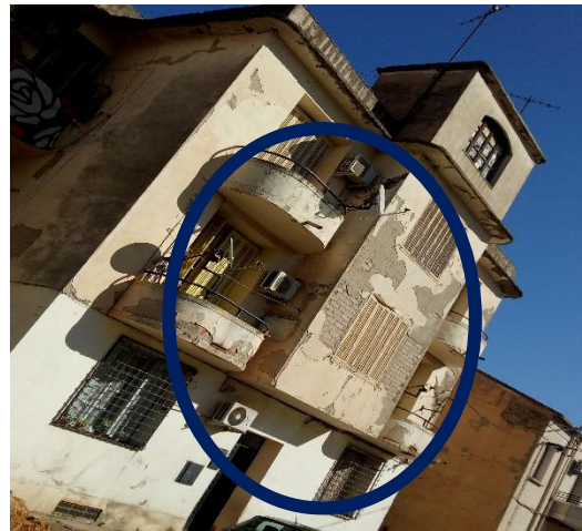
Figure n°37 : habitat collectif dans un état dégradé (le boulevard)
