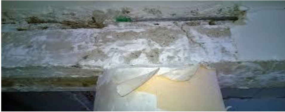
Figure II.1 Fissures d'une poutre.
