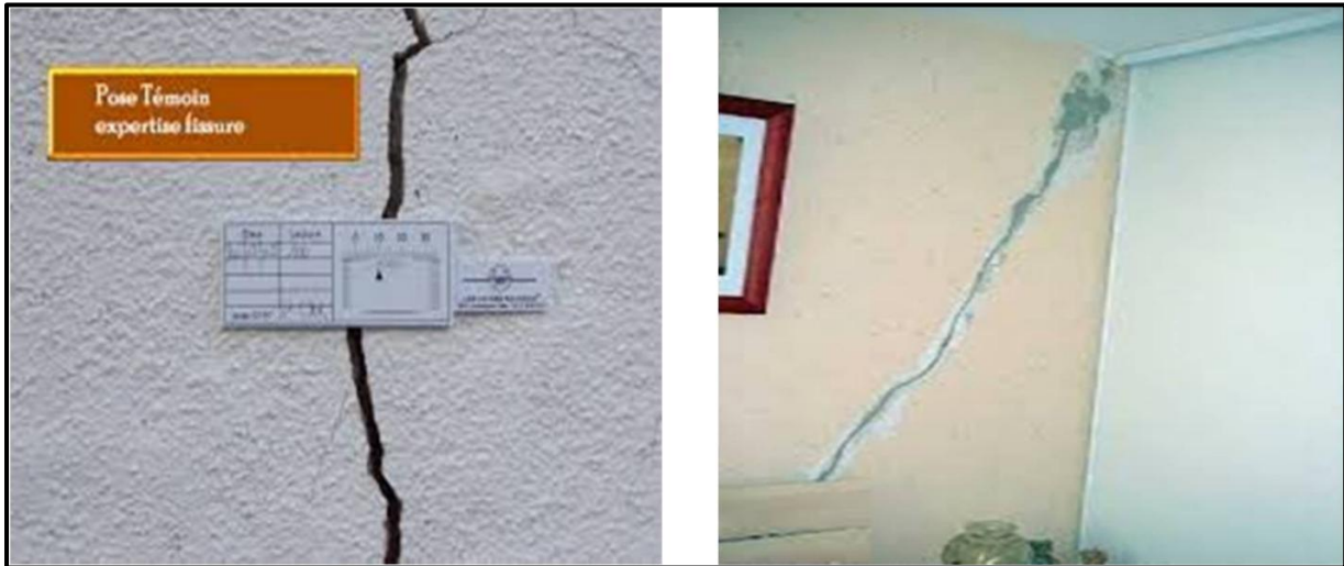
Figure II-16 : Fissure de béton
