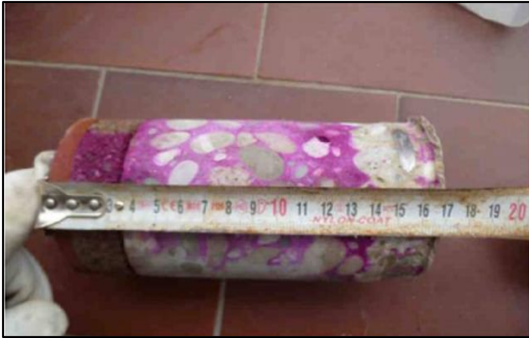
Figure III-7 : Carbonatation sur carotte.
