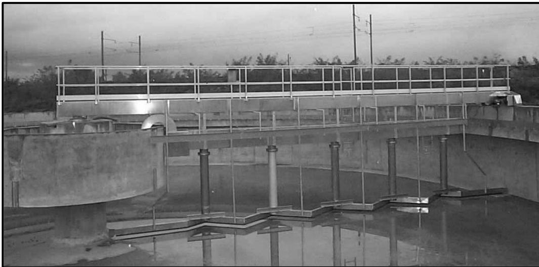
Figure I-21 : Clarificateur à pont suceur.
