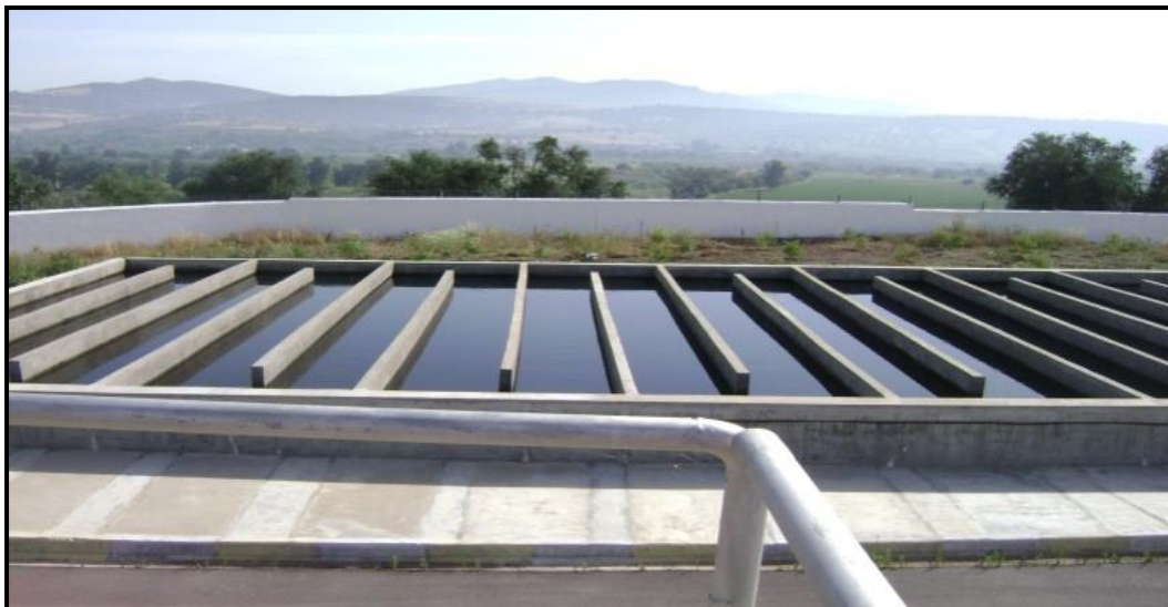
Figure I-15 : Bassin de désinfection.
