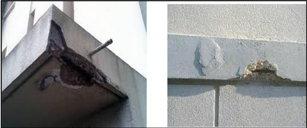
Figure II-19 : Epaufrure dans construction.
