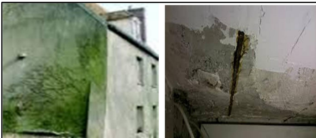
Figure II-20 : Lichen sur la structure.
