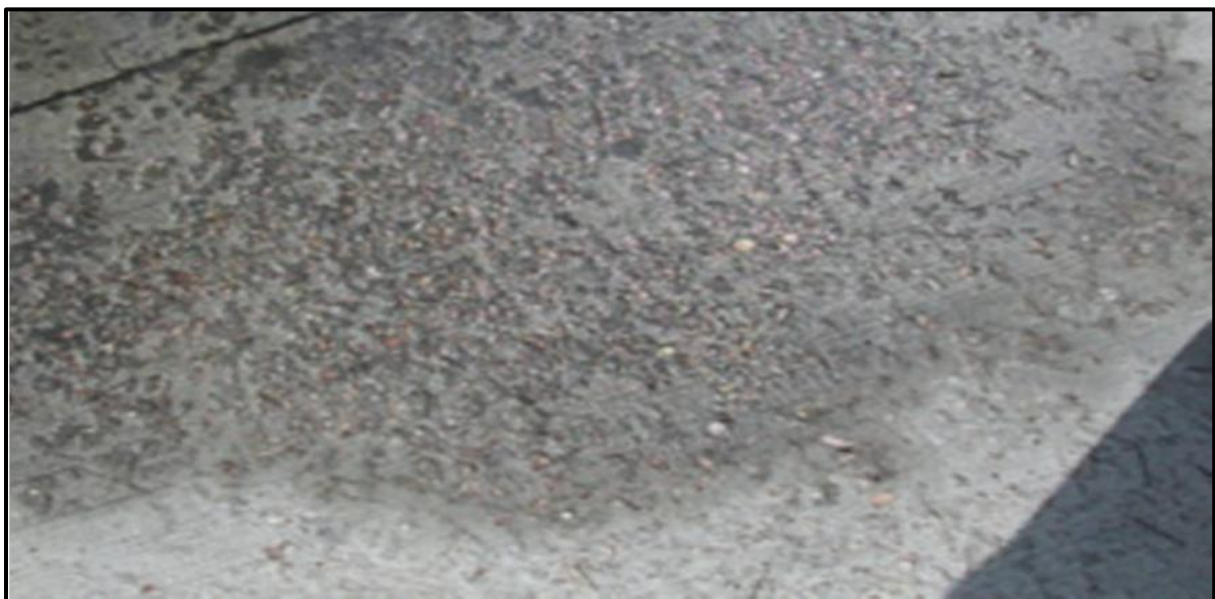
Figure II-6: dégradation due aux sels de déverglaçage.
