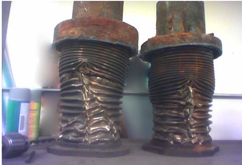
Figure (1.2) : Joints d'expansion détruits par le coup de bélier.
