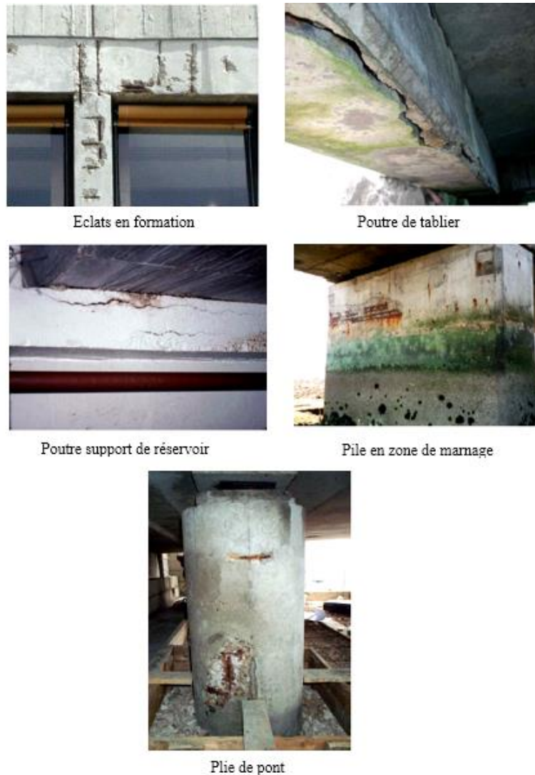
Figure III.6 Différents types de dégradations.
