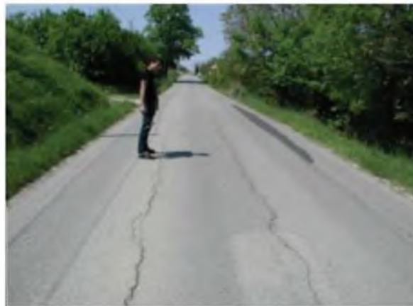
Figure 2.7. Fissuration longitudinale de routes due au retrait et gonflement des sols.
