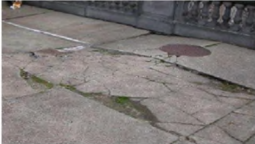
Figure 2.10. Présente des fissures sur la chaussée en raison du soulèvement dû au gel.
