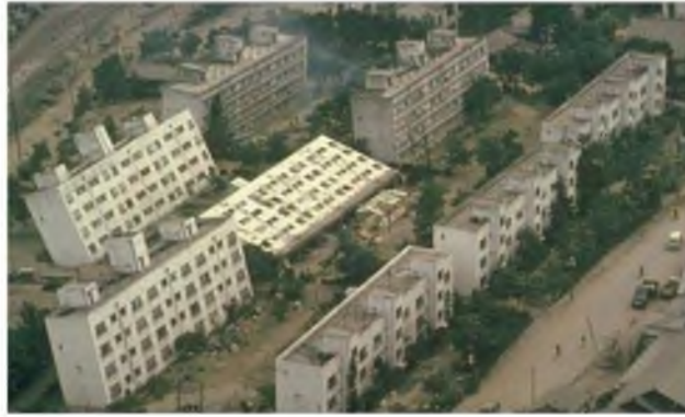
Figure 2.8. Immeubles partiellement enfouis et ayant basculé à la faveur d'une liquéfaction du sol lors du séisme de 1964 à Niigata, au Japon.
