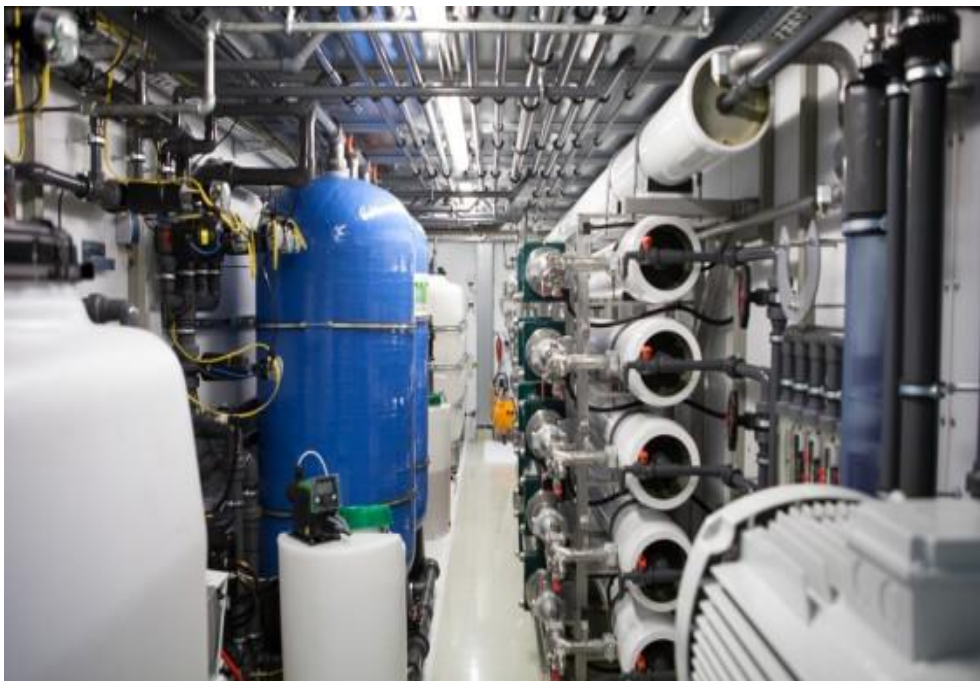
Figure 37 : Installation d'osmose inverse pour le traitement des eaux
