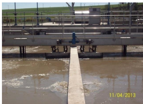
Figure. 2.3 : Bassin de dessablage-déshuilage-dégraissage. (Source STEP de Guelma)
