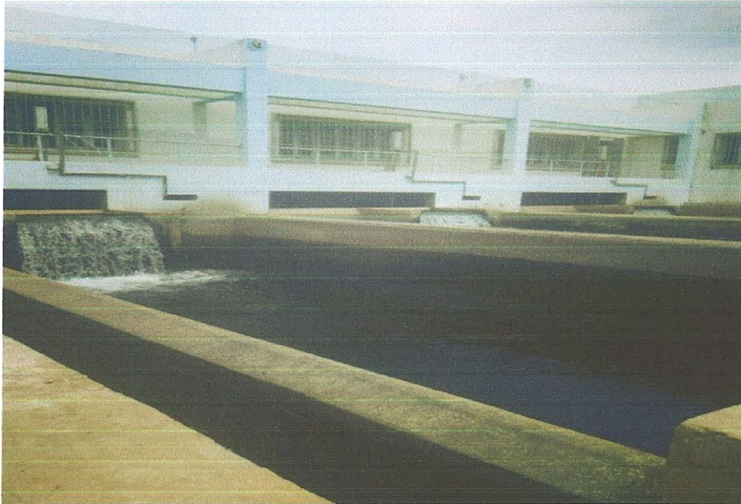
Figure 9 : l'étape de filtration de l'eau brute.
