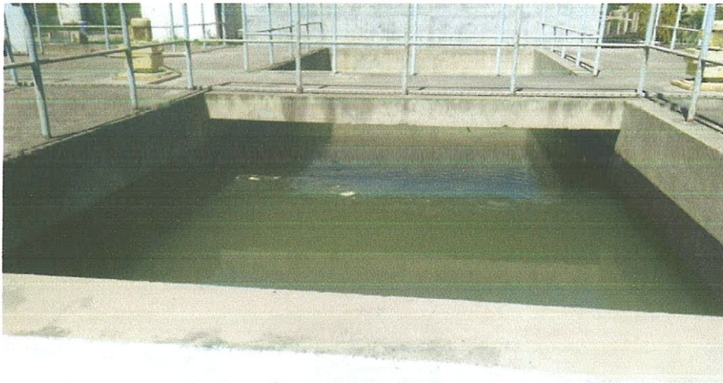
Figure 07 : l'étape de floculation de l'eau brute.
