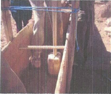
Figure 22: Compactage de la terre à l'aide d'un pilon (ou épissoir), Source : Google image
