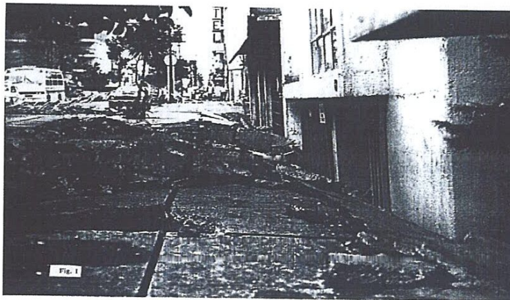
Figure 2.10 : Désordres observés sur une fondation superficielle d'un immeuble de petites dimensions fondé sur radier
