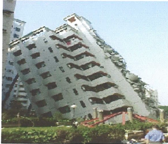
Figure 2.18 : Les fondations ne descendaient pas au delà de la zone liquéfiante. Une couche supérieure d'argile de résistance mécanique apparemment suffisante pour un radier peut dissimuler une couche liquéfiante profonde.
