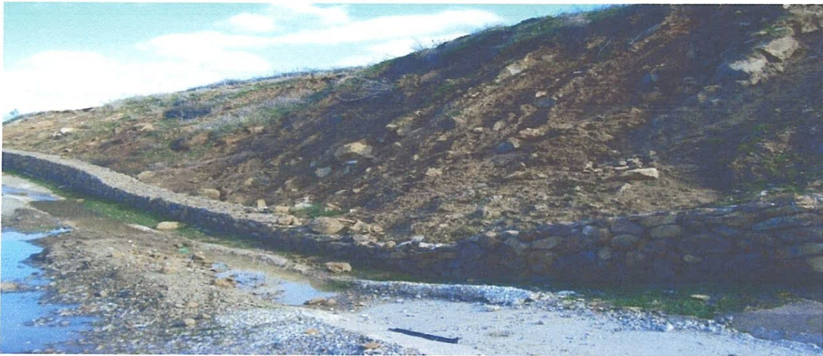
Photo 4.6 Glissement au niveau de la pente
