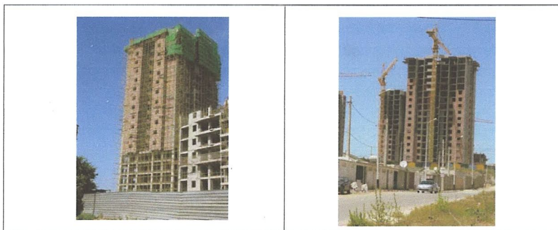
Figure II-1. Bâtiment en cours de construction avec voiles en béton armé, Très bonne résistance à l'action sismique [11]
