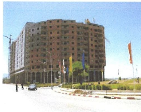
Figure II-4. Bâtiment en cours de construction dont la sauvegarde est due à la présence des cages d'ascenseur en voile en RA.
