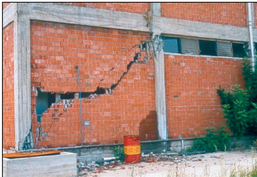
Figure 2.6 Endommagement de remplissage causant le cisaillement des poteaux.
