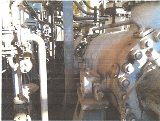
Figure III.2. Les trois compresseurs en série plus la turbine
