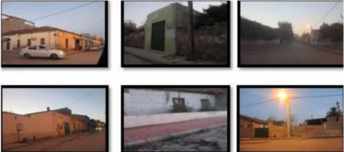
Figure 41: habitations dégradées Source : Auteur
