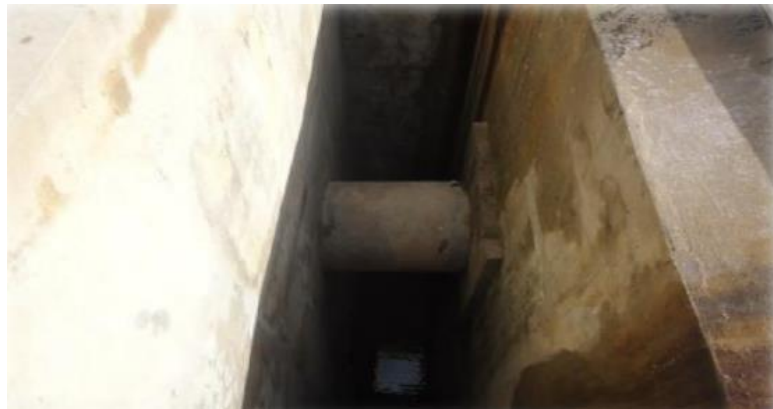
Figure II. 1. Canal d'amenée des eaux brutes (station Hammam Debagh).
