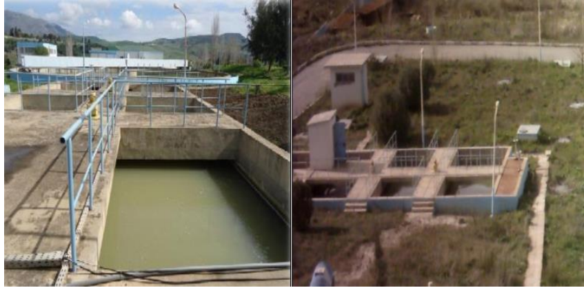
Figure II. 2. Bassin de mélange (Station Hammam Debagh).
