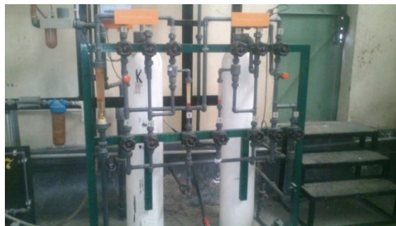
Figure I.23 : Station de traitement de l'eau déminéralisé
