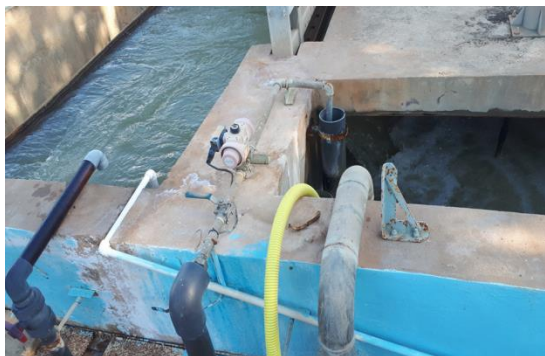
Photo 1 : Bassin de mélange (coagulation, floculation).
