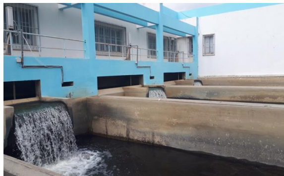
Photo 2 : Filtration sur sable.
