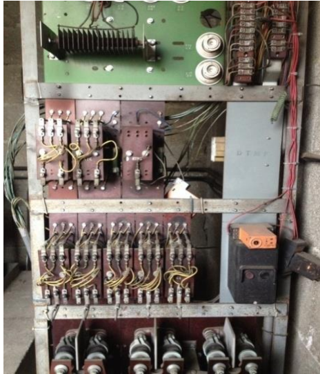
Figure (1.17) : armoire de commande
