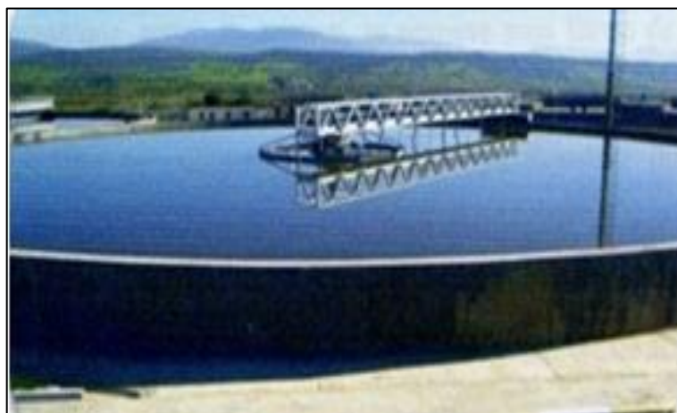
Figure 06 : Décanteur primaire (ONA, 2012).
