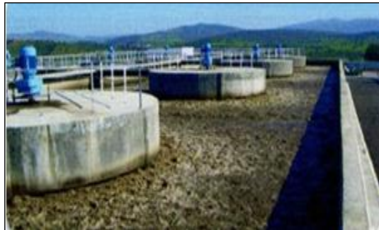
Figure 07 : Bassin d'aération (ONA, 2012).
