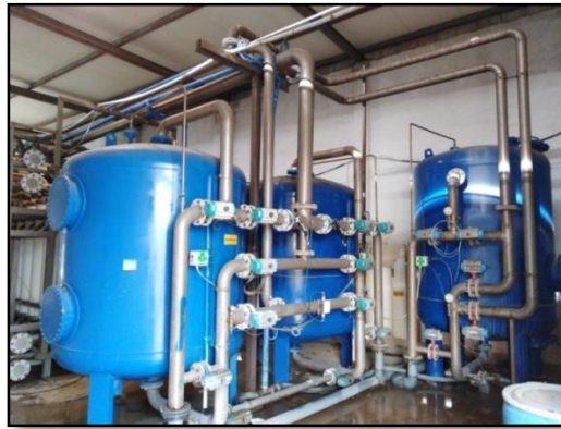
Figure 09 : Déferrisateur (photo prise par NOUADRI, 2019).
