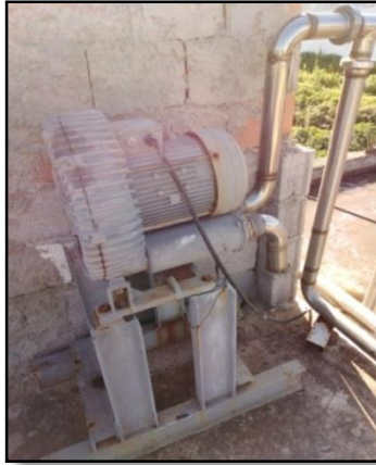
Figure 24 : Souffleur d'air (photo prise par NOUADRI, 2019).
