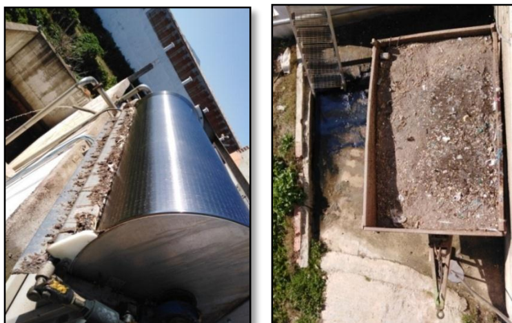
Figure 21 : Filtre dégrilleur et l'évacuation de déchets vers les bennes de décharge (photo prise par NOUADRI, 2019).
