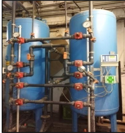
Figure 10 : Filtre à charbon actif (photo prise par NOUADRI, 2019).
