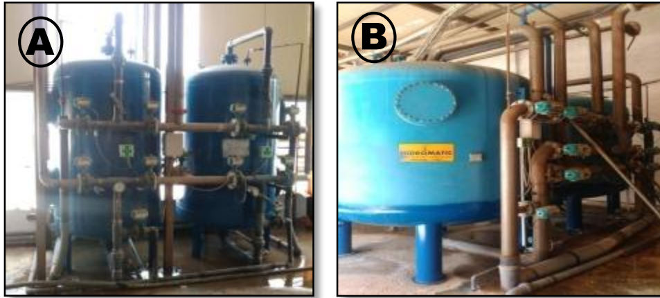
Figure 06 : Filtres à sable de 1200 m 3 (A) / 2400 m 3 (B) (photo prise par NOUADRI, 2019).
