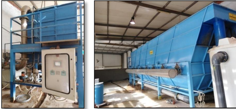
Figure 04 : Décanteur (photo prise par NOUADRI, 2019).
