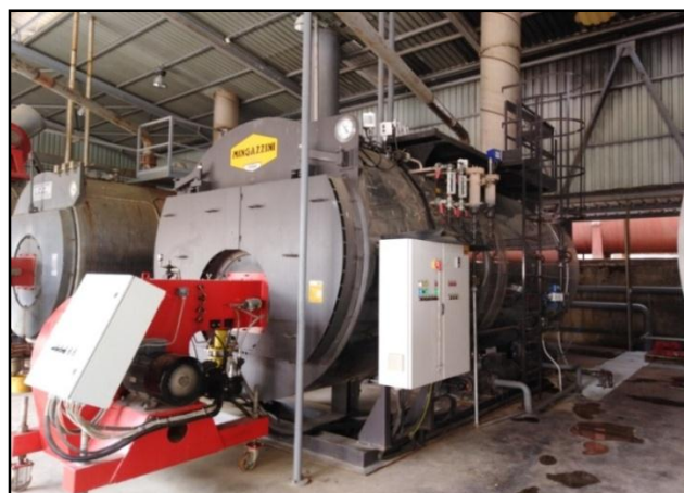
Figure 13 : Chaudière (photo prise par NOUADRI, 2019).
