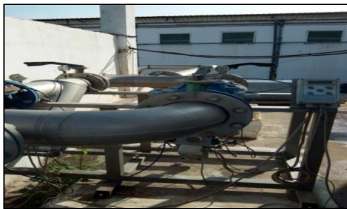
Figure 03 : Filtre autonettoyant (photo prise par NOUADRI, 2019).
