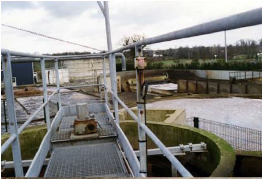
Figure 12: Clarificateur d'une station d'épuration
