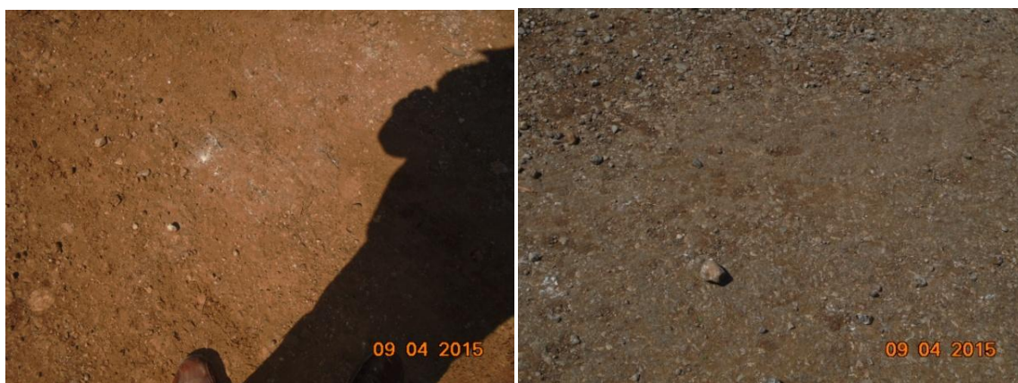
Figure 10 : Etat de la couche de roulement
