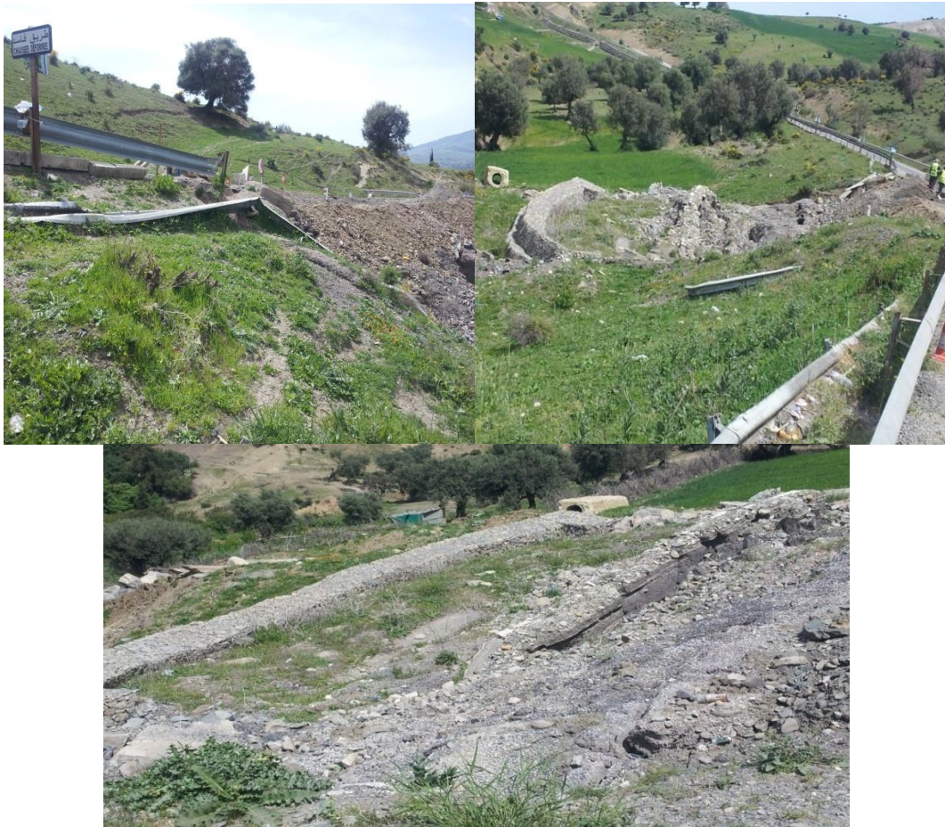
Figure V.4. Photos représentant le glissement des débris d'un mur réalisé pour confortement
