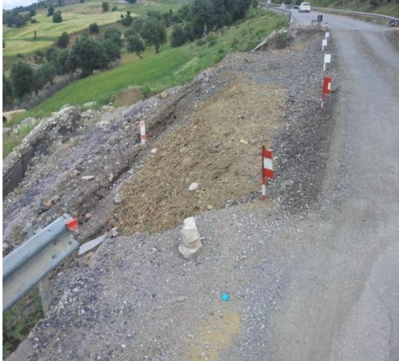
Figure .V.3. La limitation du glissement sur la partie aval de la chaussée
