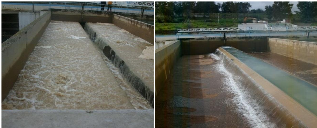
Figure 24 : Le filtre au cours et après le lavage
