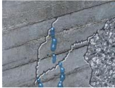
étanchéité en surface de structure en béton ayant des fuites
