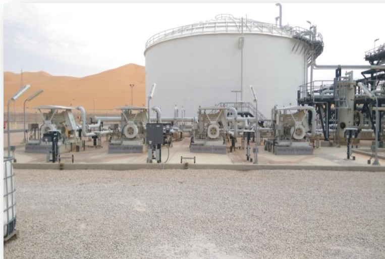
Figure.VI.19 : Les pompes booster d'eau produit du TAGI (P08 5201A / B / C / D).
