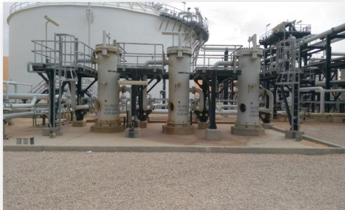
Figure.VI.20 : Les filtres d'eau produit du TAGI (S08-5201A / B / C).
