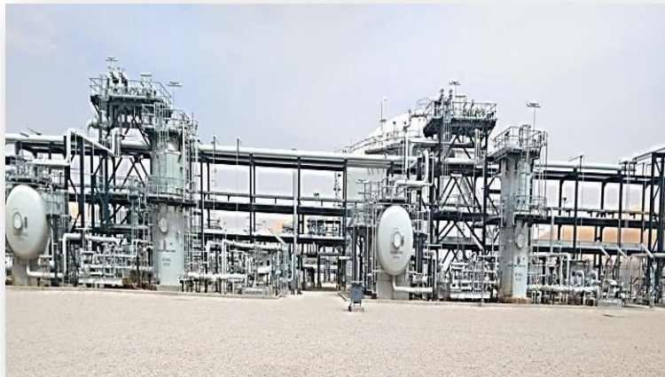
Figure.VI.8 : Unité traitement d'eau produite du TAGI.
