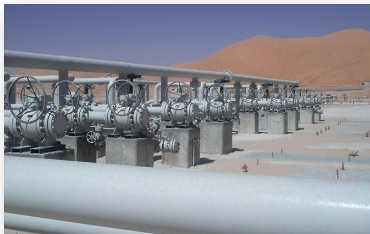
Figure.II.8 : Station de collecte et de pompage (FGS).
