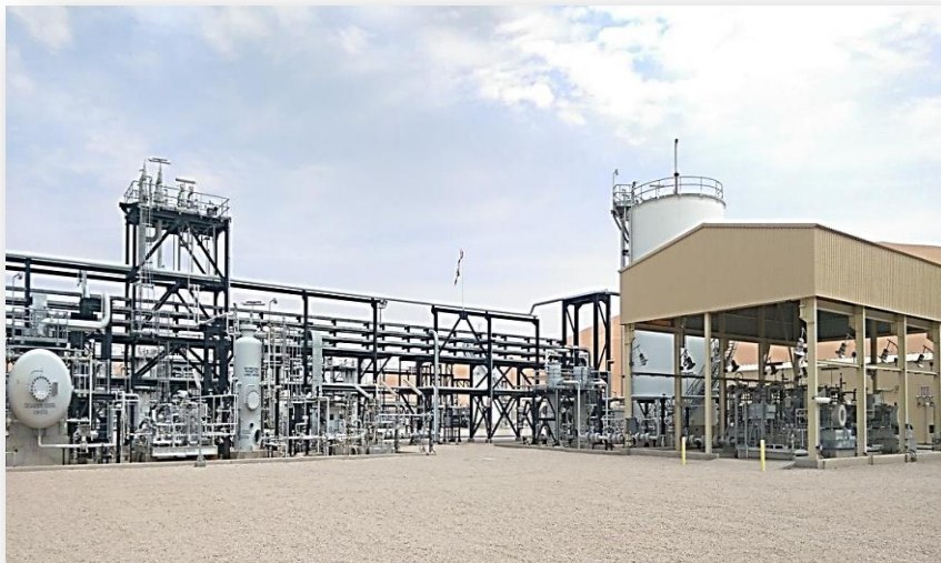
Figure.VI.9 : Unité de traitement d'eau produite de RKF/STR.
