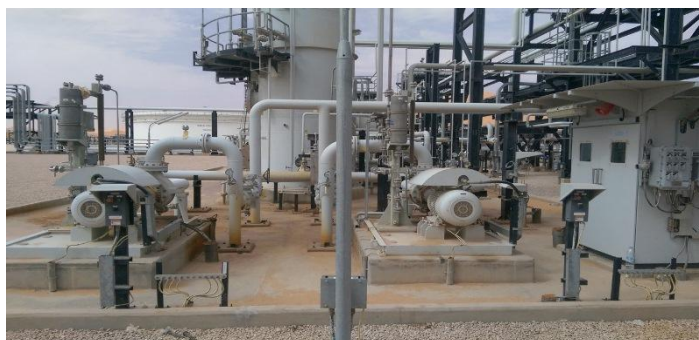
Figure.VI.15 : Pompes d'eau produite traitée du TAGI.
