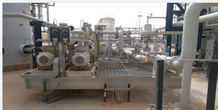
Figure.VI.14 : Pompes de recirculation d'eau d'IGF (P01/02-5102A/B).
