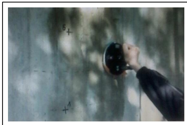
Photo III.2.4 : Mesure de vitesse de corrosion
