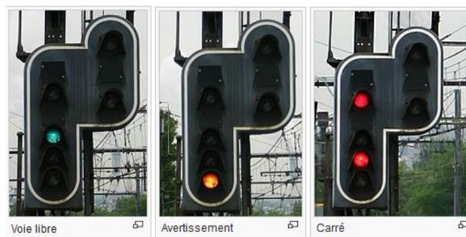
Figure 67 : Exemple d'une signalisation lumineuse
