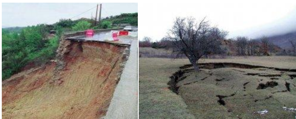
Figure 1.10. Exemples de glissements de terrains.
