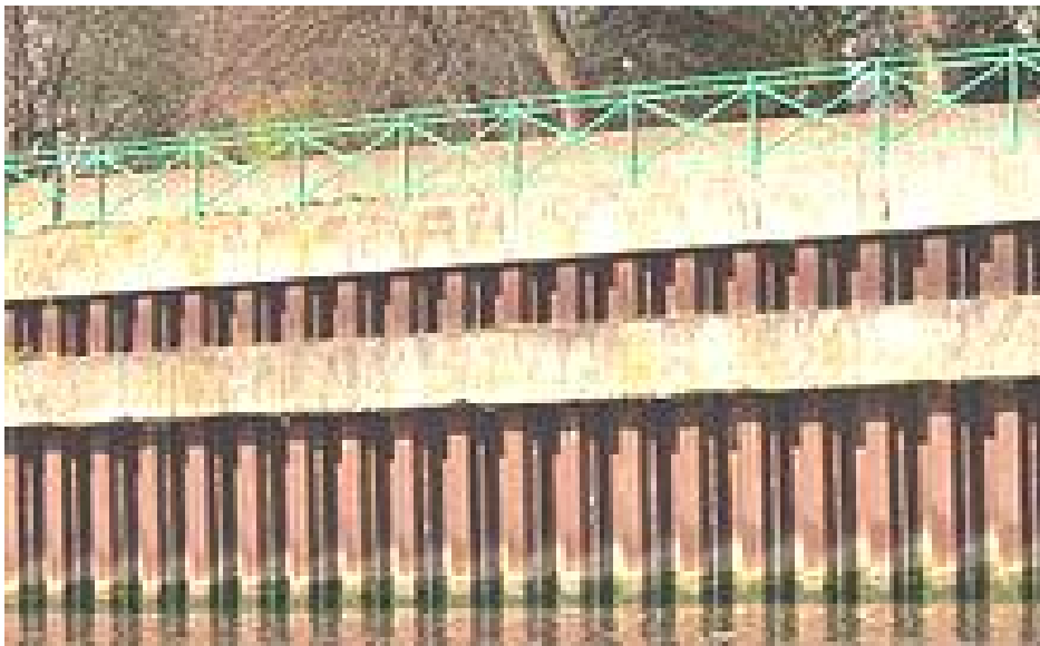
Figure 2.9. Berges en palplanches sur la Deûle à Lambersart (Nord de la France).
