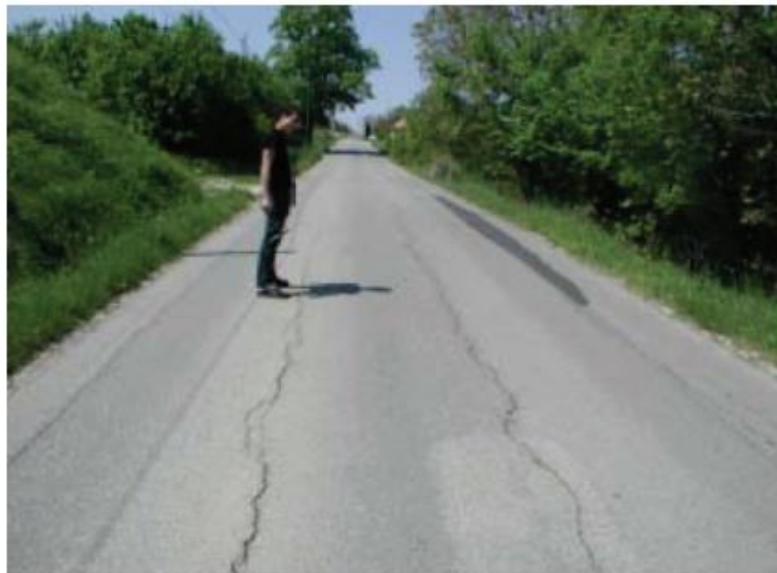
Figure 2-2 : Fissuration longitudinale de routes due au retrait et gonflement des sols.
