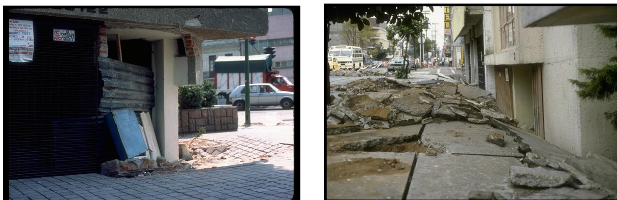
Figure II.10. Endommagements des structures au niveau de la fondation après le séisme de Guerrero-Michoacán (Mexique, 1985).
