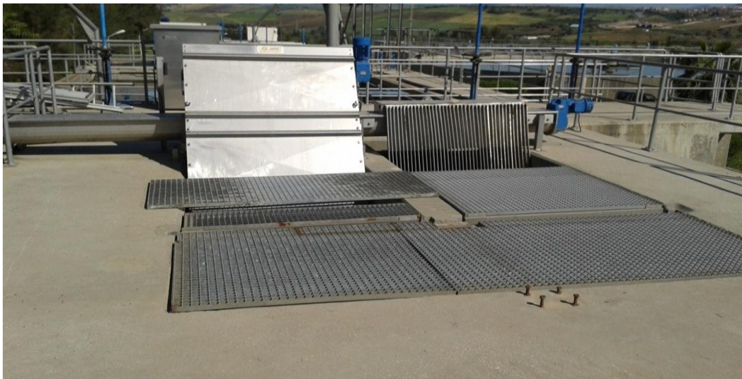
Photo (1-2) : Dégrilleur (STEP Guelma, 2015).
