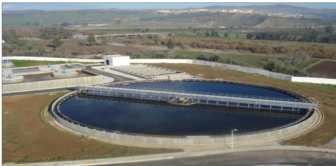
Photo (1-6) : Bassin de clarification (STEP Guelma, 2015).
