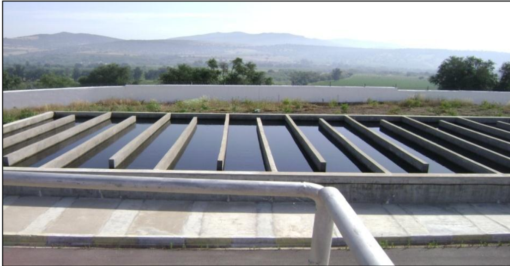
Photo (1-7) : Bassin de désinfection (STEP Guelma, 2015).
