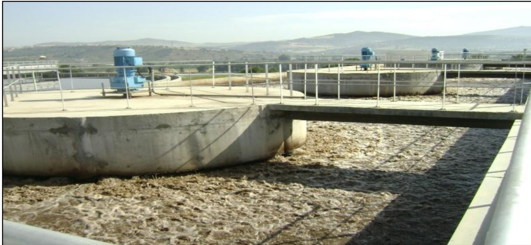
Photo (1-5) : Bassin de traitement biologique (STEP Guelma, 2015).
