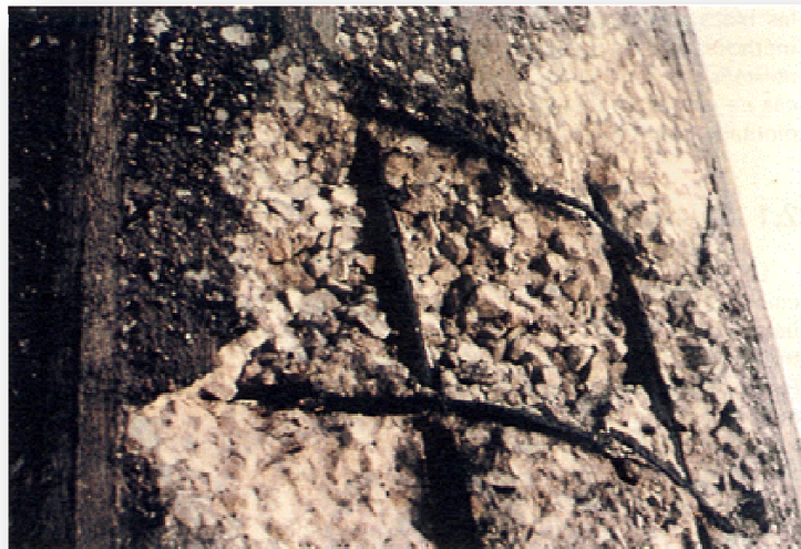
Figure 9 - Dégradation du béton due à l'insuffisance d'épaisseur
