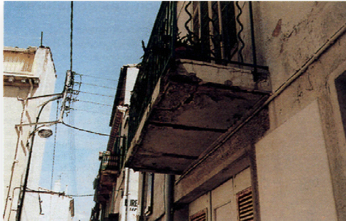
Figure 6 - Corrosion de l'armature métallique d'un balcon. Sous l'effet de la corrosion des armatures, le béton armé de recouvrement s'est fissuré et a éclaté. Ces destructions mettent en cause la stabilité de ce balcon
