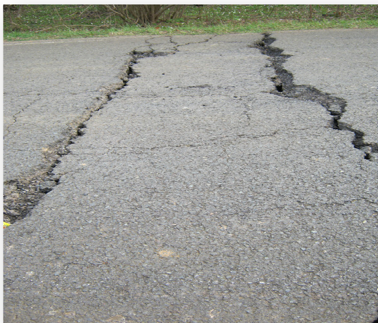
Figure 1 : Les affaissements d'une route
