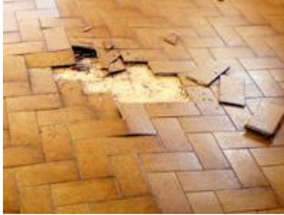
Photo III.3: Décollement des carreaux
