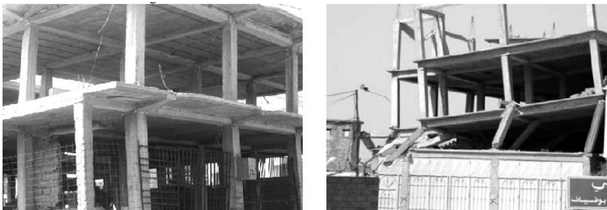
Figure I.14. Dégâts occasionnés dans des structures auto-stables en phase de réalisation
