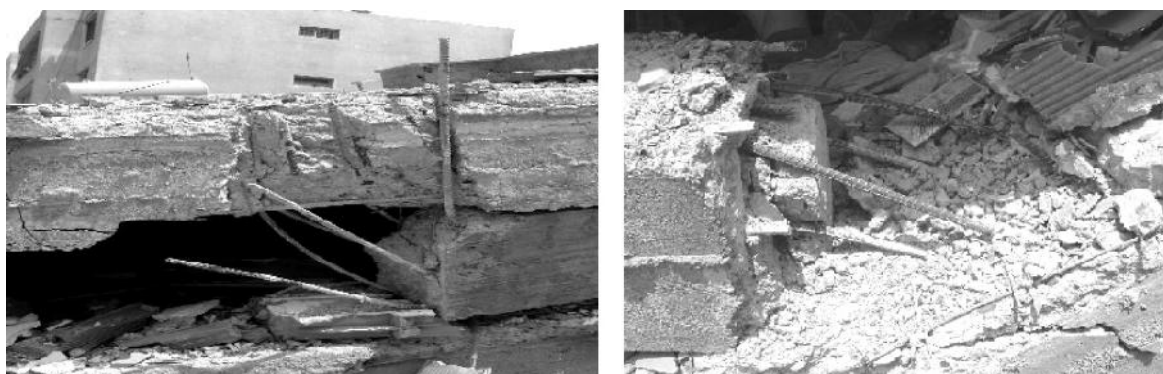
Figure I.13. Rupture des nœuds par arrachement des armatures longitudinales
