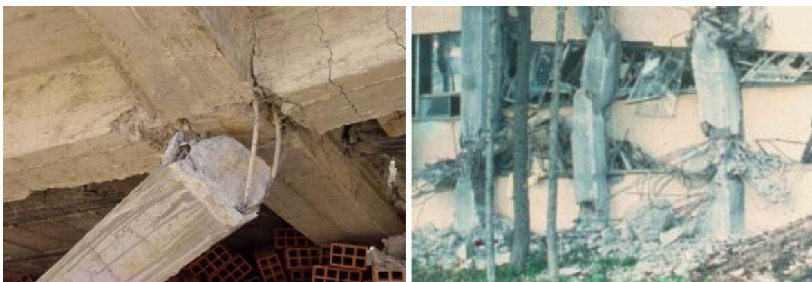
Figure I.15. Plastification des poteaux avant les poutres
