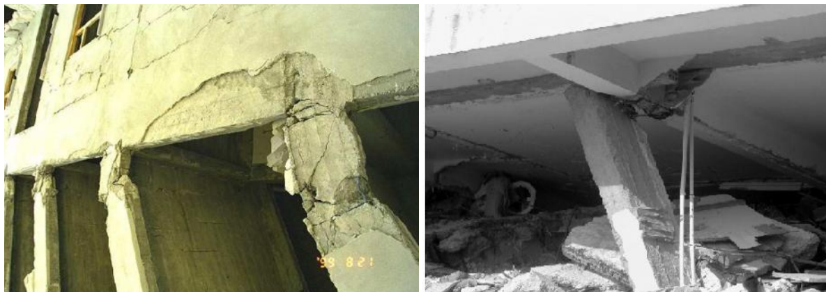
Figure I.21. Effondrement de bâtiment par manque de contreventement longitudinal
