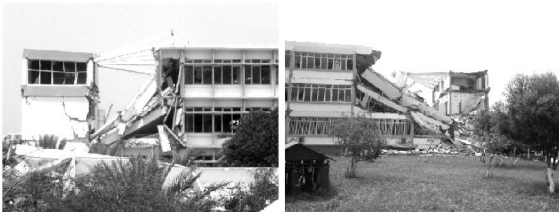
Figure I.19. Effondrement partiel d'un bâtiment faute de mauvaise conception
