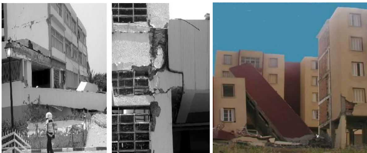
Figure I.18. Endommagement par un ouvrage voisin Boumerdes 2003 suite à une erreur de conception
