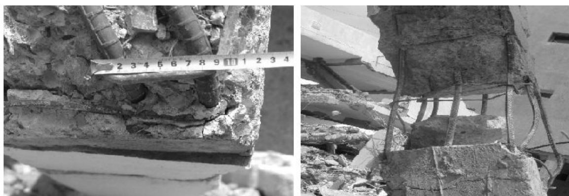
Figure I.22. Mal façons constatées séisme de Boumerdes (2003)
