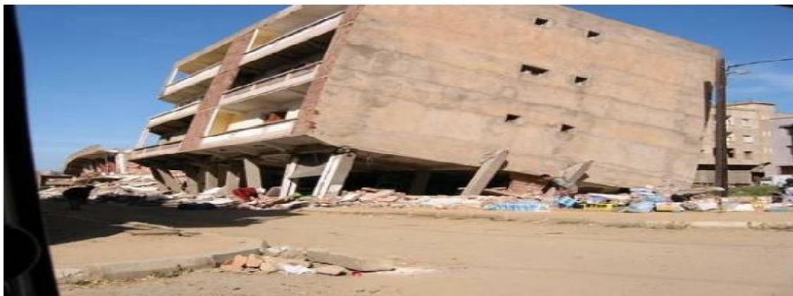
Figure I.17. Effondrement de la structure sur le RDC
