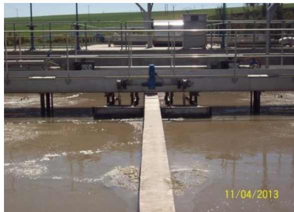
Figure 10 : Bassin de dessablage-déshuilage-dégraissage. (Source STEP de Guelma)
