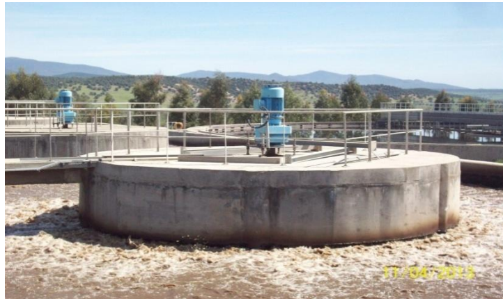
Figure 12 : bassin d'aération. (Source STEP de Guelma)
