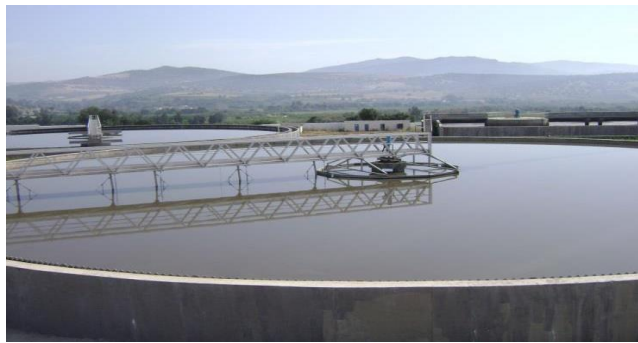
Figure 11 : Bassin décanteur. (Source STEP de Guelma)
