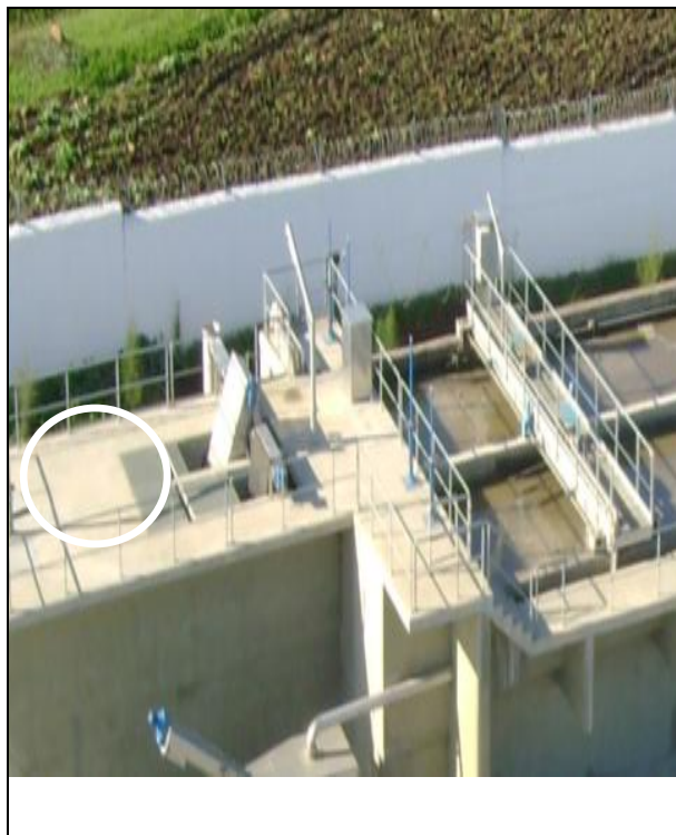
Fig.III.7 L'eau brute entré de STEP
