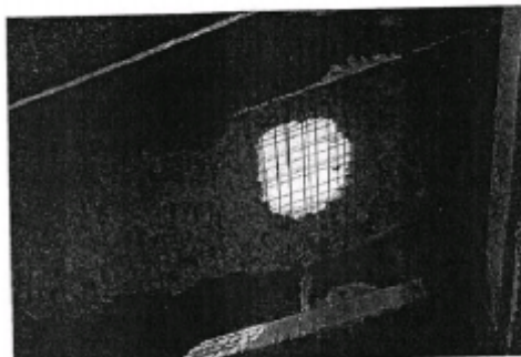
Fig. I.2 : Délamination du béton d'un hourdis de pont aboutissant à la formation d'un trou
