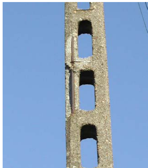
Fig. I.15 : Poteau support de ligne électrifiée
