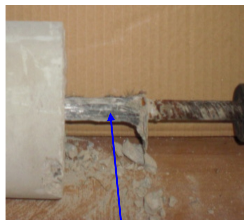
Tissu intact et enlèvement d'un très petit cône de béton
