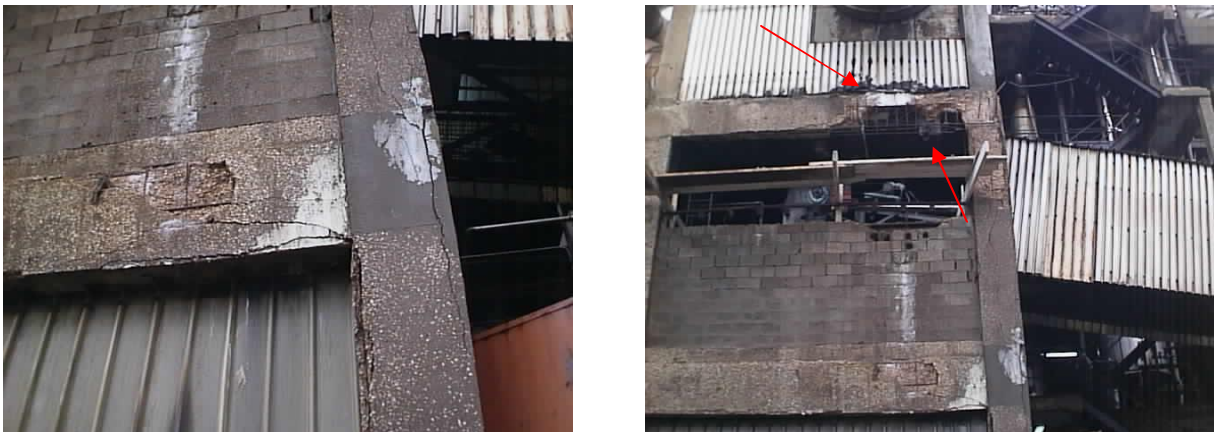
Fig. I.23. . Dégradation des poutres d'une structure du complexe de fabrication d'engrais (nitrate d'ammonium) Annaba [C4]
