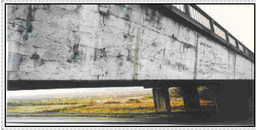
Figure II - 7. Fissuration dans l'ouvrage du la réaction alcali-silice
