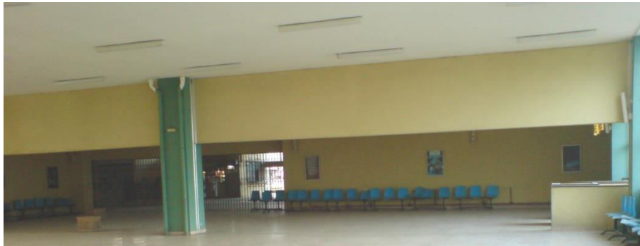
Fig105 : Retombée de poutres.
