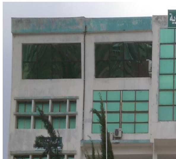
Figure 63: absence de l'élément de protection
