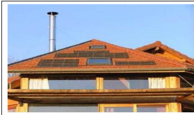
Figure 19 : Les panneaux solaires photovoltaïques de la maison de proche de Gap
