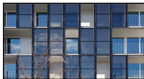
Figure 16 : Panneaux solaires thermiques à tubes sous vide
