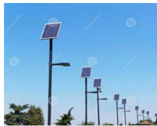
Fig. 51 : Poteau Electrique à Panneau Photovoltaïques
