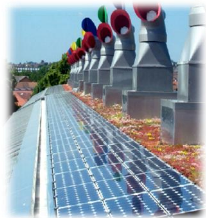
Figure 71: vue sur les panneaux solaires.
