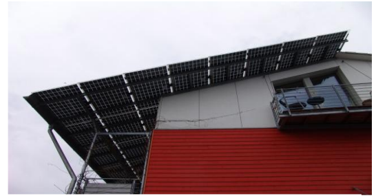
Figure 56: Maison passive avec installation des panneaux photovoltaïques qui forme sa toiture
