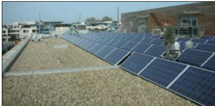
Figure 41: Intégration des capteurs en toiture terrasse.
