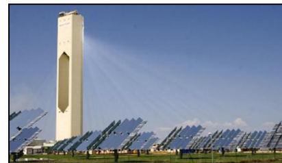
Figure 31: Le central à tour. Source : GIZ/ Michael Netzhammer.
