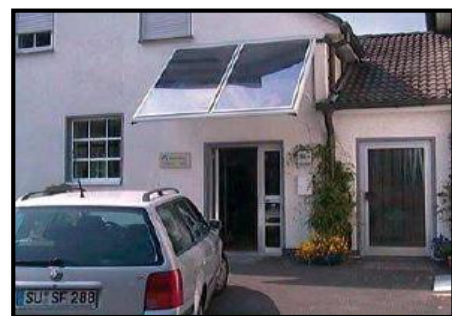
Figure 45: Les capteurs solaires en décrochement de façade.
